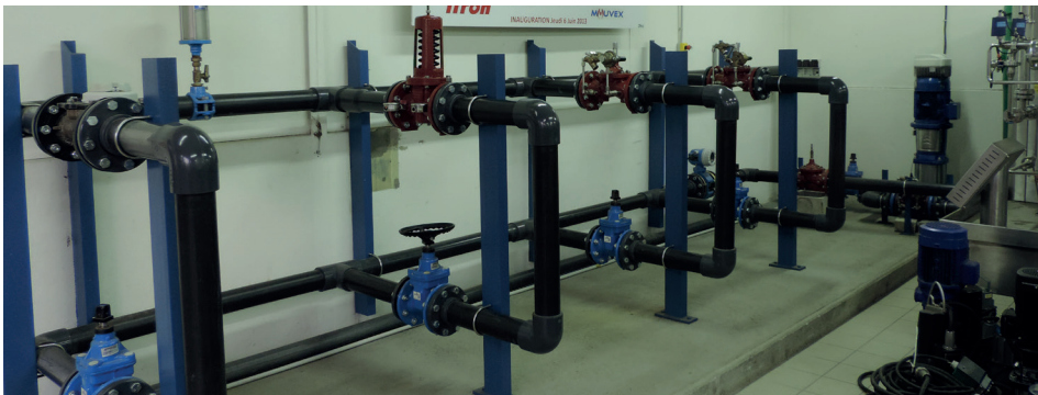
Le hall hydraulique Bancs pédagogiques de simulation de réseaux hydrauliques
