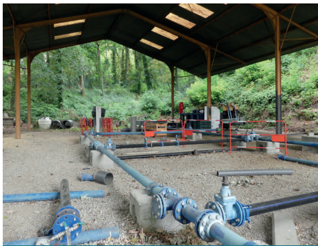
Le hangar hydraulique Simulation réseau eau potable
