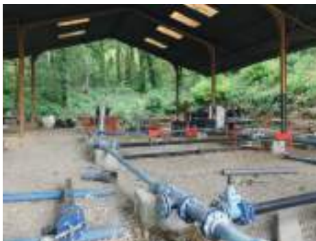
Le hangar hydraulique Simulation réseau eau potable
