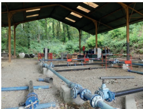
Le hangar hydraulique Simulation réseau eau potable
