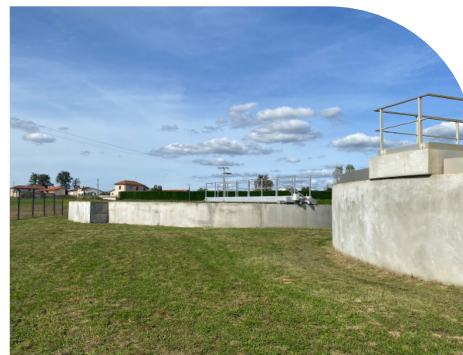
Visite de la station d'eau potable de l'Aix
